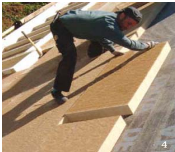
Figur 10: Utvendig isolering av tak med lette plater som etterpå inndeckes med undertaksplate. Overliggende lekteverk festes til sperrene med lange rustfrie stålskruer. Tilsvarende metode benyttes for vegg. Foto: Gutex.
