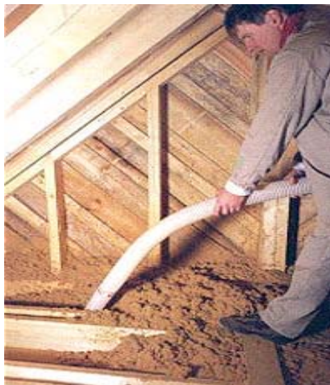
Figur 5: Defibrert tremasse i bjelkelag
